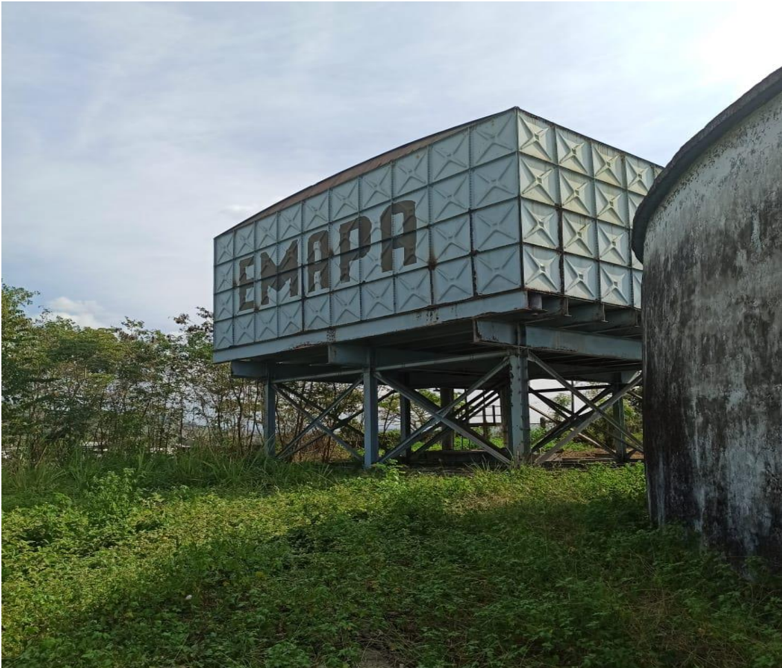
Imágen 6: Tanque 1200 m3 sin operatividad
