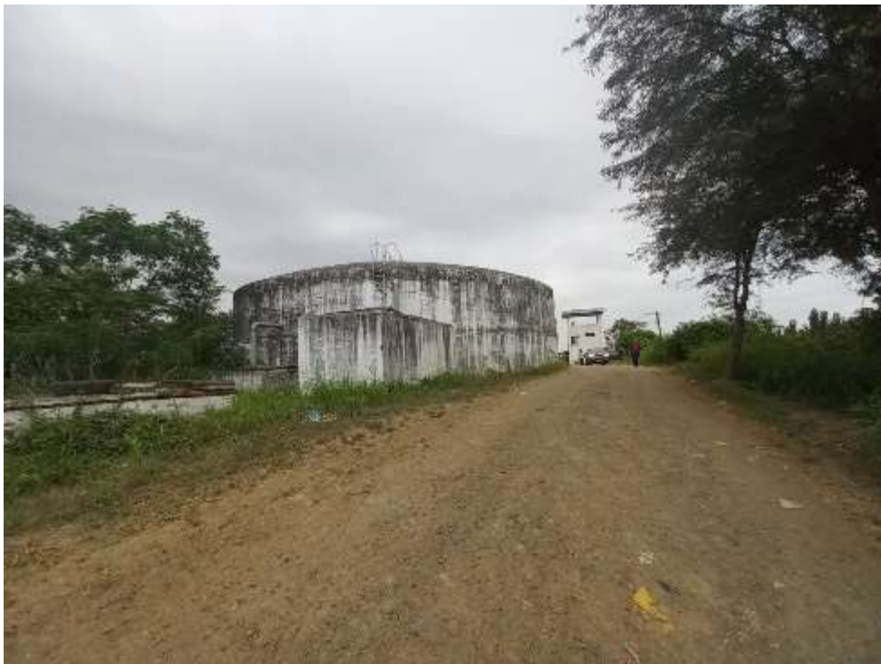
Ilustración 5: Tanque de Reserva de 2.000 m 3
